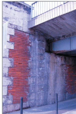
Salétromos lefolyások a Baross-híd hídfőjénél
