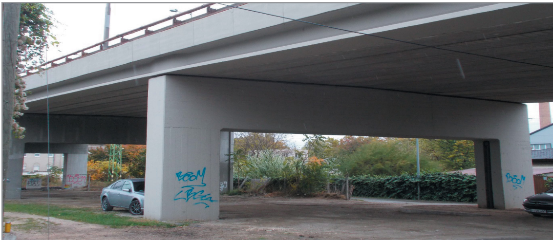
Kifejezetten rossz arányú alátámasztás az Ipar úti felüljáró alatt
