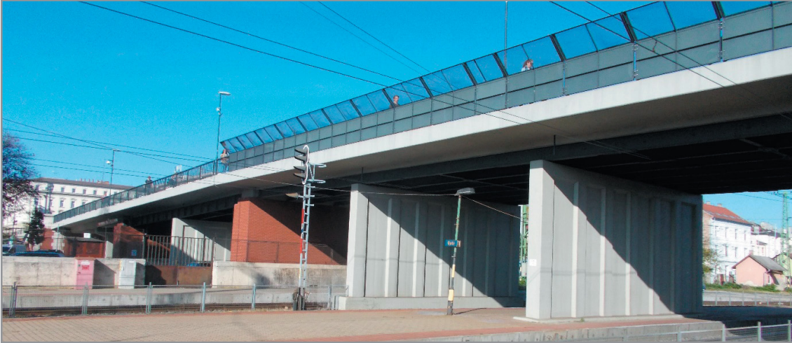
A Baross-híd szerkezete napjainkban: az egykor egységes kőkváderes téglapillérek helyett ma téglát imitáló kerámiaburkolat, és vasbeton pengepillérek tartják az útpályát
