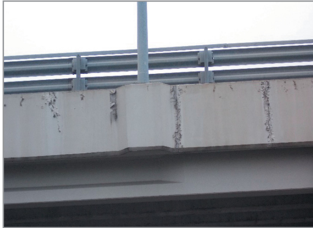
Külső Fehérvári úti felüljáró: az előregyártott panelek összerosott hézagai már néhány év használat után bántó módon jelennek meg.
