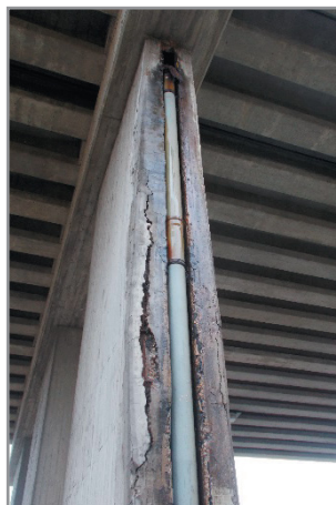
Az esővíz elvezető rendszer hibája és főleg karbantartásának elmaradása miatt károsodott pillér a Széchenyi-hídon
